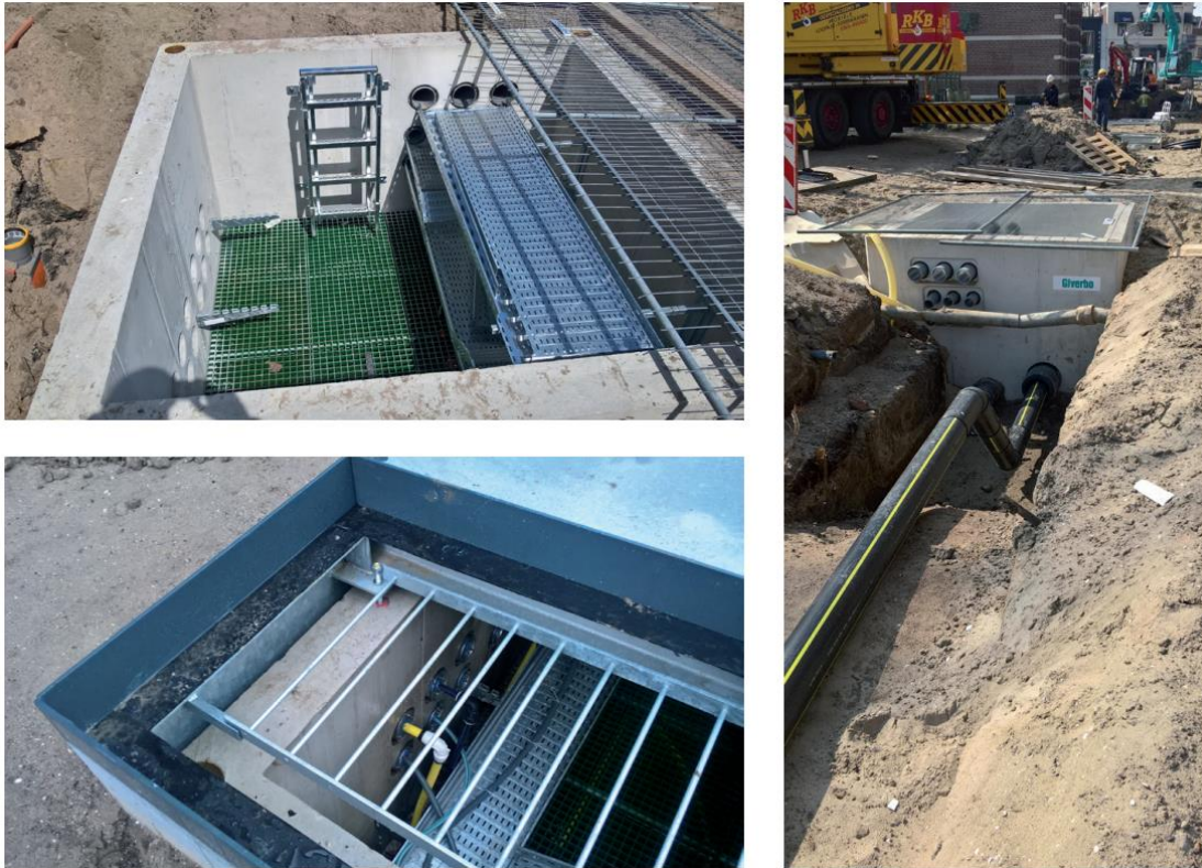
Figuur 9. Voorbeeld van inspectieputten in een gezamenlijk leidingtracé (bron: cob.nl )
